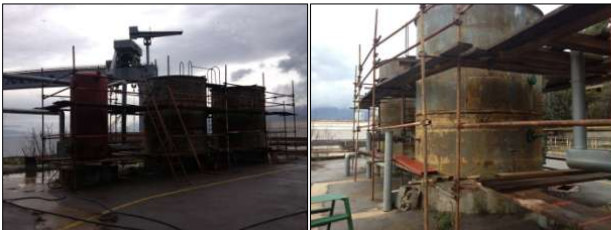
Slika 12: Spremnici otpadne tehnološke vode
