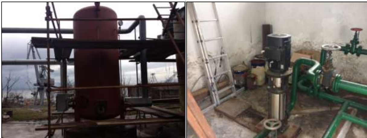
Slika 14: Pumpna stanica vode
